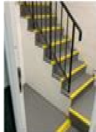
Stair Edge Markings
